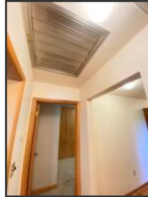
Whole house fan
